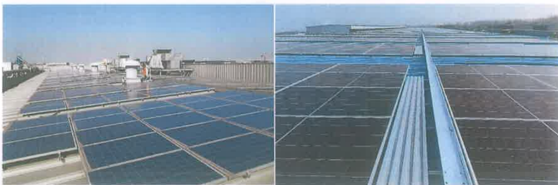
分布式屋顶光伏现场照片
