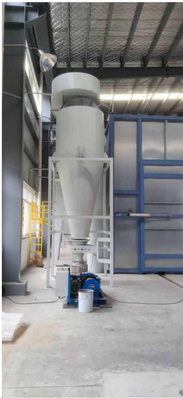
抛丸粉尘废气处理设施
