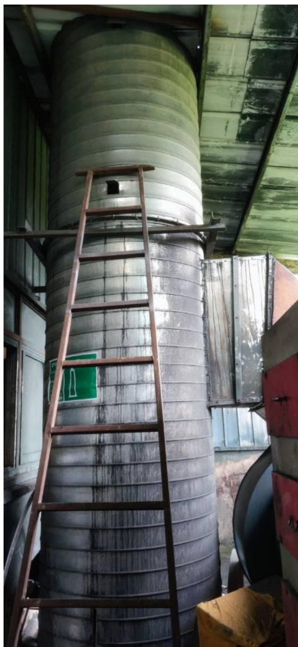
喷漆废气排气筒及标识牌
