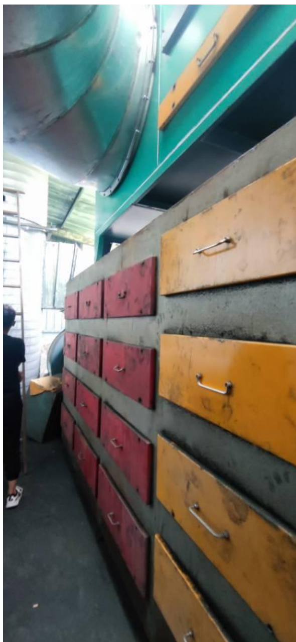
喷漆废气处理设施
