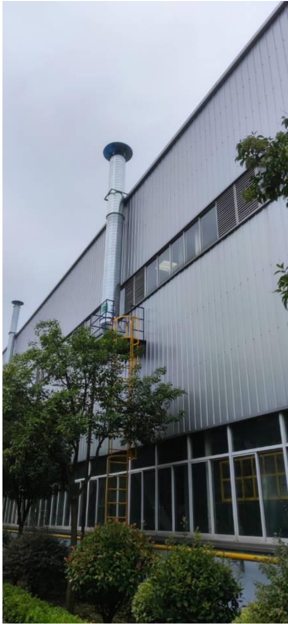
喷塑废气排气筒及标识牌
