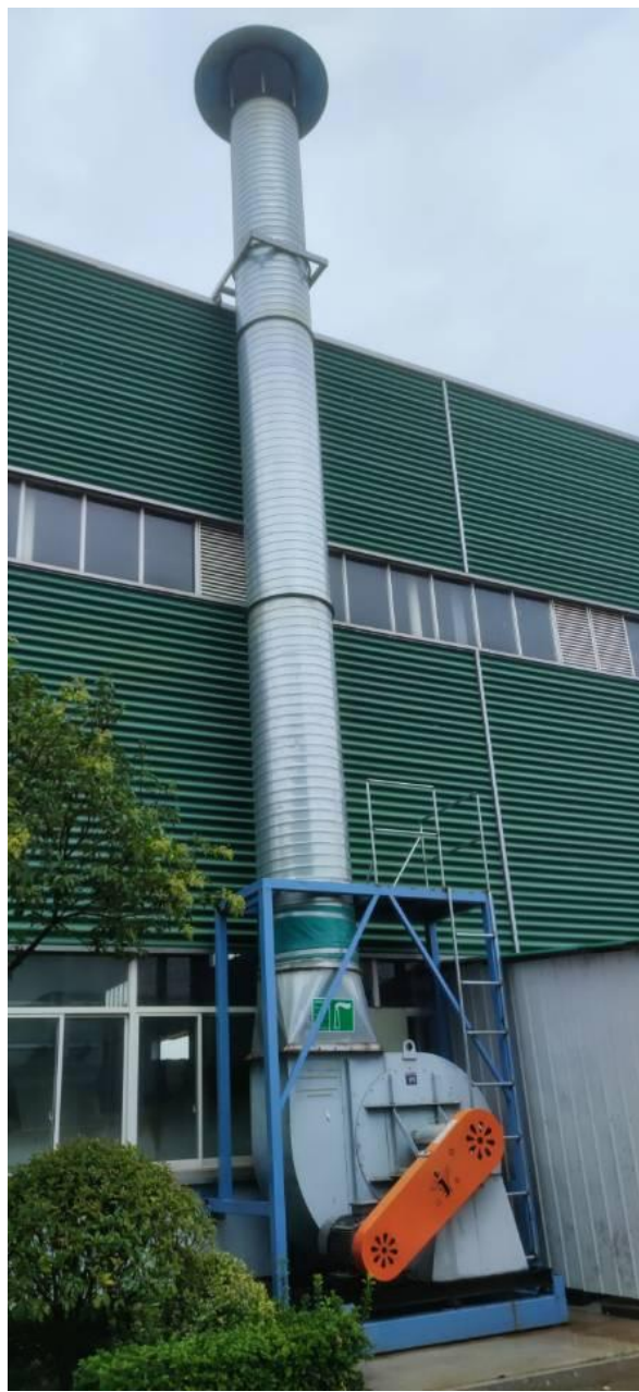
抛丸粉尘废气排气筒及标识牌
