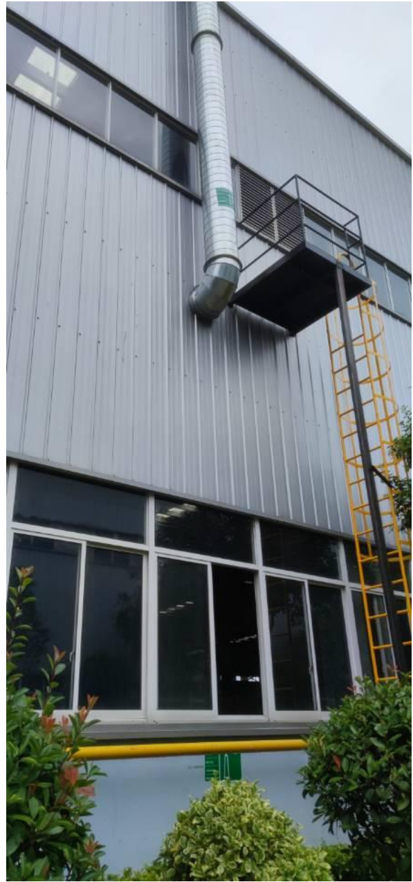
喷塑烘干废气排气筒及标识牌
